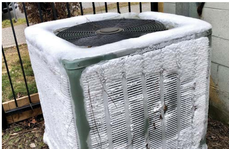
Slika 8.9: Potpuno zaleđeni isparivač kod toplotne pumpe u režimu grijanja
